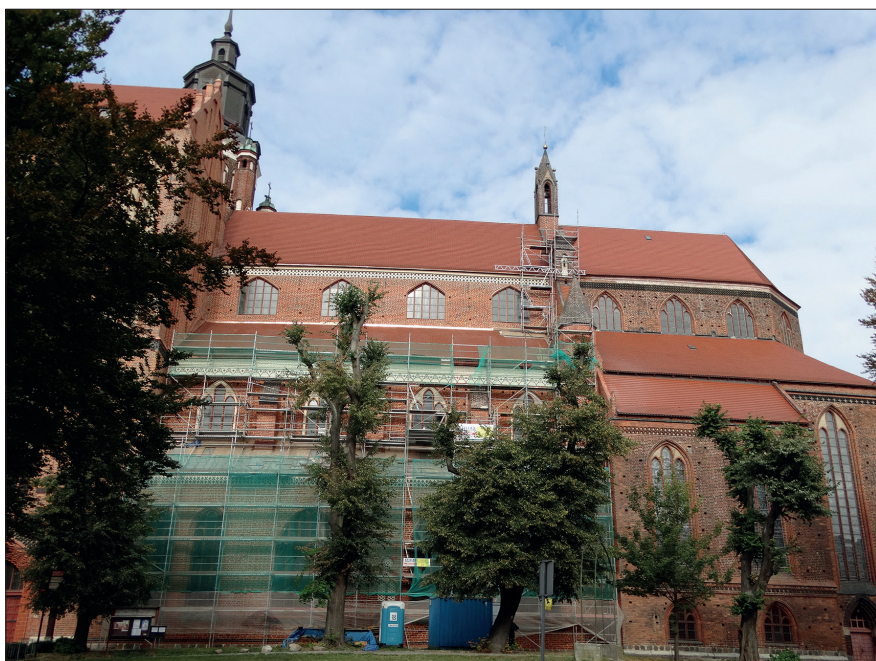
Ryc. 2. Elewacja południowa Kościoła Mariackiego w trakcie prac renowacyjnych, wg stanu z 5 października 2018 r. Fot. A. Bierca MAH w Stargardzie
