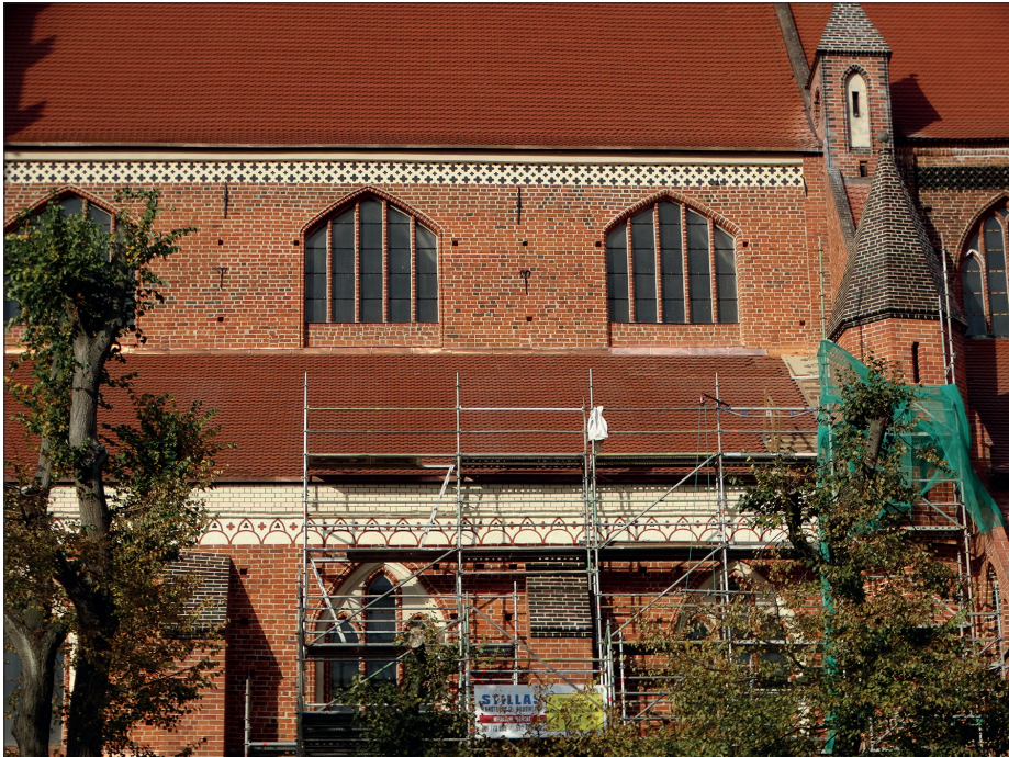
Ryc. 3. Elewacja południowa Kościoła Mariackiego w trakcie prac renowacyjnych, wg stanu z 3 listopada 2018 r. Fot. A. Bierca MAH w Stargardzie
